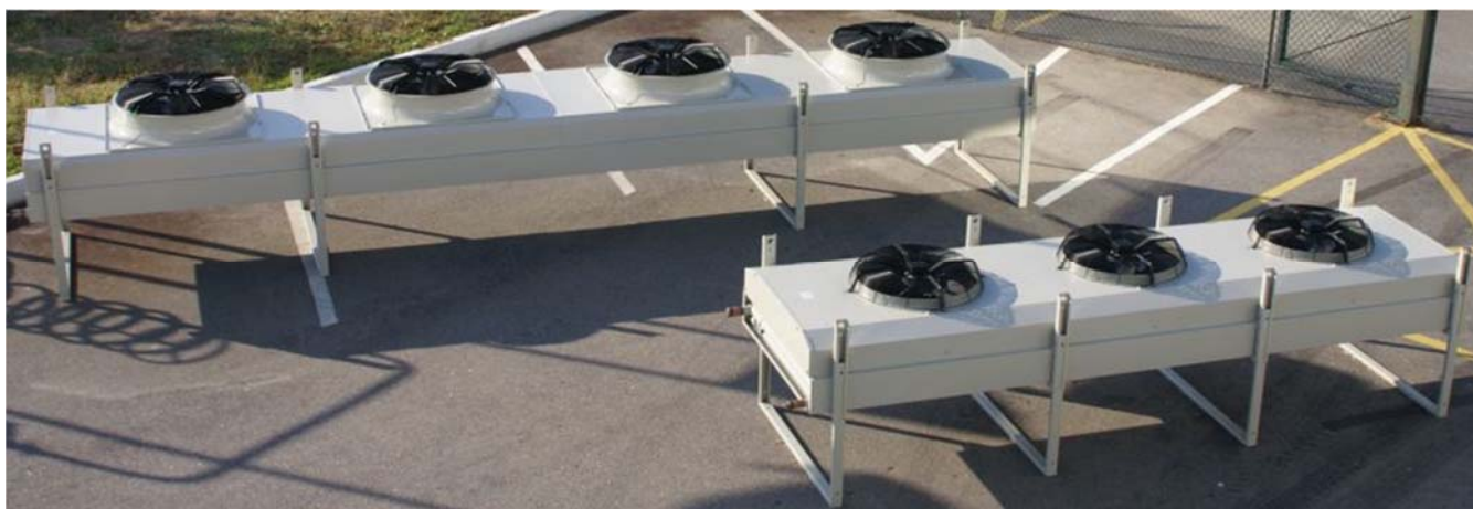
Condensadores ACI e ACP ACI and ACP condensers
